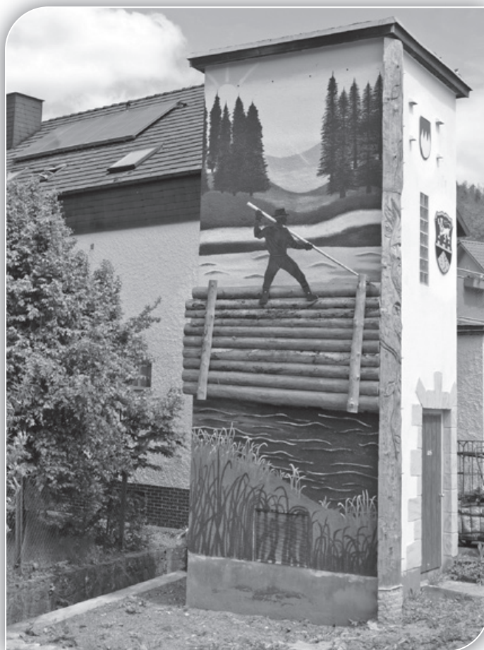
Auf Initiative des OGV Steinberg verwandelte sich die Trafo-Station in der Steinberger Ortsmitte in einen wahren Hingucker.
